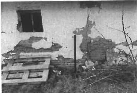
19. Vakolat lepergés - gazdasági épület
