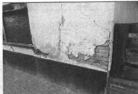
8. Vakolat lepergés - homlokzat
